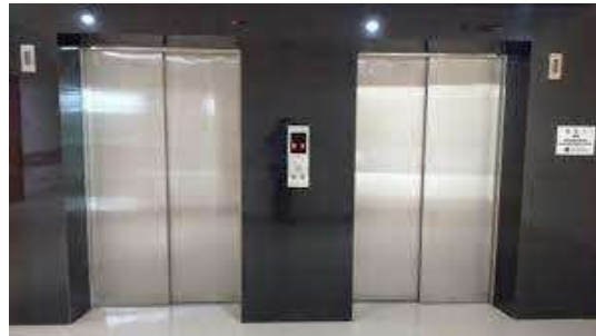
Gambar 57. Pintu lantai pemberhentian lift
